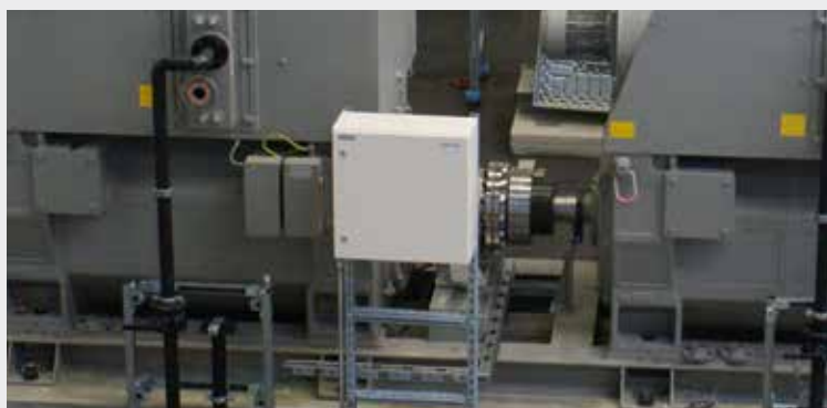
Kein freies Wellenende an Verbindungswelle zwischen Tandemmotoren/ No free shaft end at connection shaft between tandem motors
