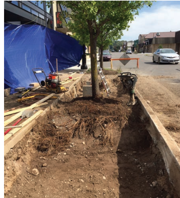
Teilweise wurzelnackte Ginkgo-Straßenbäume sind für den neuen sandbasierten strukturellen Pflanzboden vorbereitet. (Fotos freundlicherweise zur Verfügung gestellt von Stephen Stimson Associates.)
