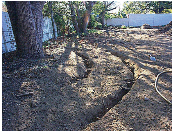
この木の周りに掘られた溝は電線導管を設定するためのものです。
