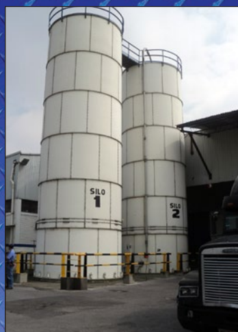
Silo esbelto de faldón
