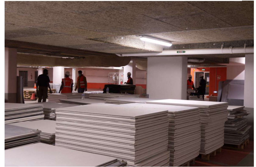
Tôle acier de plafond perforés siège social de Groupama
