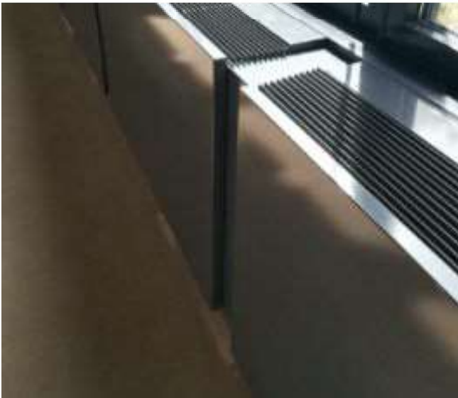
Tôle acier de ventilo-convecteur chantier Gecina Paris 17eme
