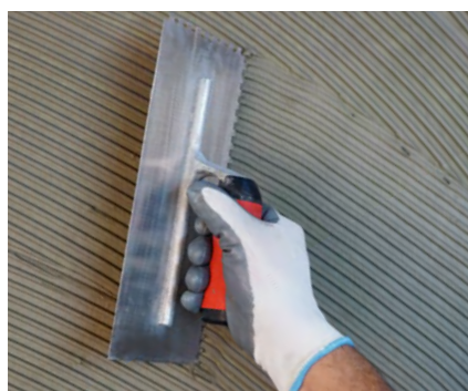
Aplicação da 1ª camada de Tubetão Microcimento G para regularização do suporte.
