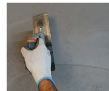
Aplicação da 2ª camada dando o efeito de espatulado para obter o acabamento final desejado.
