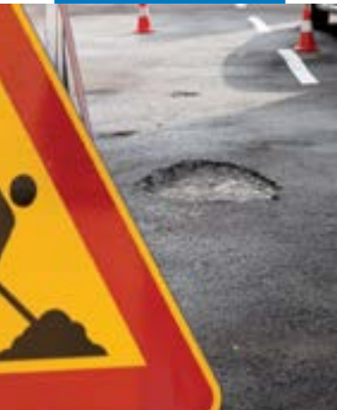
Buraco de estrada pronto para ser reparado
