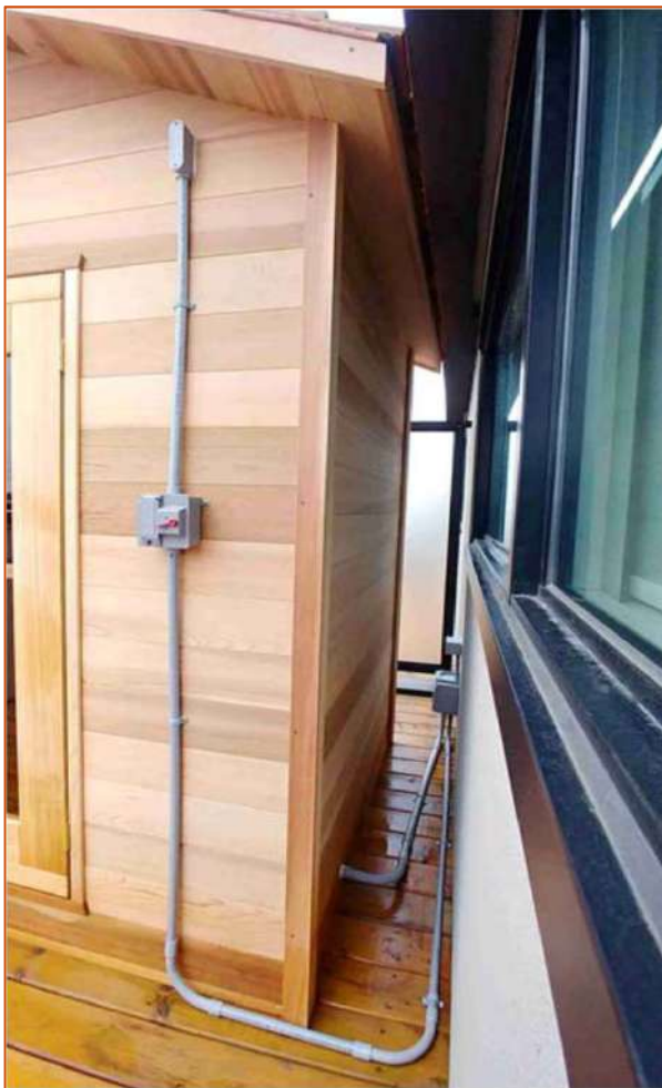
Weatherproof Conduit & Light Switch
