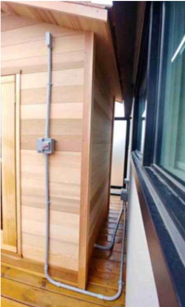
Weatherproof Conduit & Light Switch
