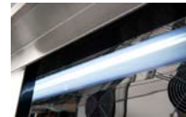
Recirculating internal fan
