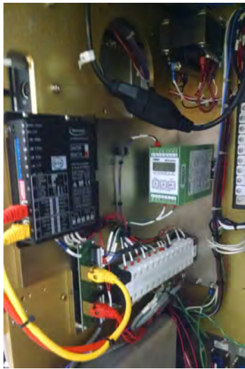
Spin Controller Retrofit
