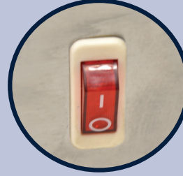
One switch per lamp
