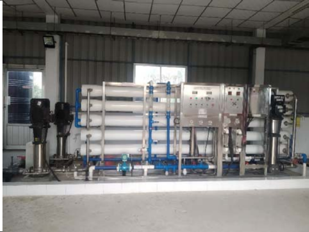
WTP [RO Unit]
