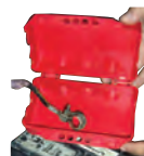
12 Volt DC Starter Batteries
