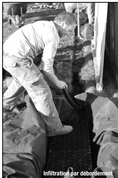
Connexion de cloison de débordement
