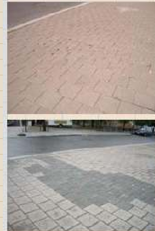
Skader på dekke av betongheller etter fasaderenovering, utbedring ved utskifting av skadde heller.
