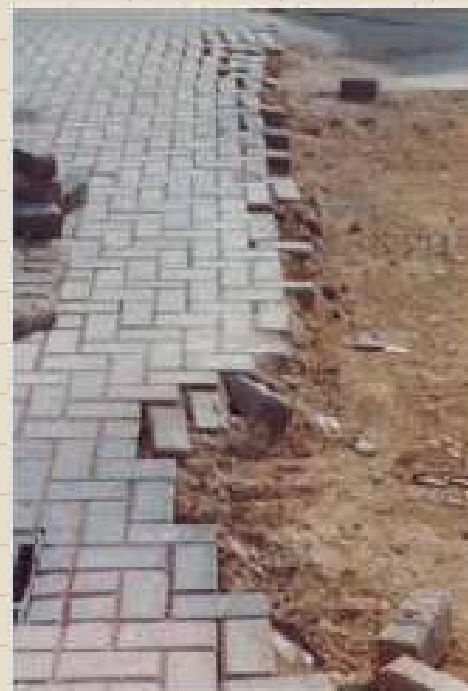
Et graverende eksempel på manglende kantavslutning.
