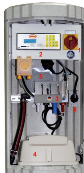
Armoire de pilotage externe ouverte
