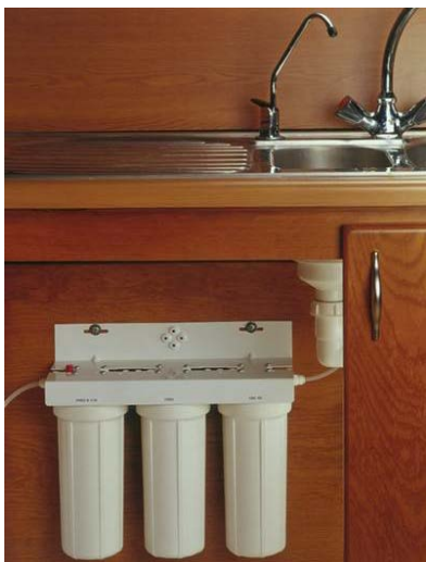
Fig. 6 Triple filtro anti sedimento arsénico y fluor debajo de la tarja con llave de salida del agua limpia en fregadero
