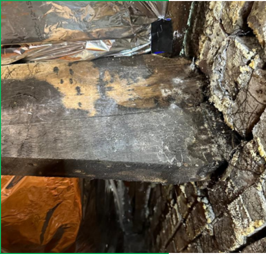
Rotte kop dwarsbalk
