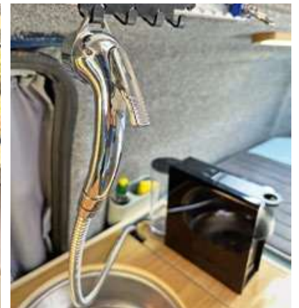
Die Handbrause von Reich ist flexibel einsetzbar, viel praktischer als ein fester Wasserhahn. Der Pumpenschalter ist am Schrank verbaut.
