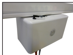
Foto 5; Cavo del carrello collegato
