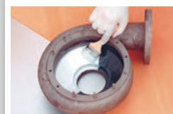
Al aplicar Brushable Ceramic por toda la superficie de la reparación con epóxico se obtiene un acabado de baja fricción que aumenta la vida útil y eficiencia de la bomba.
