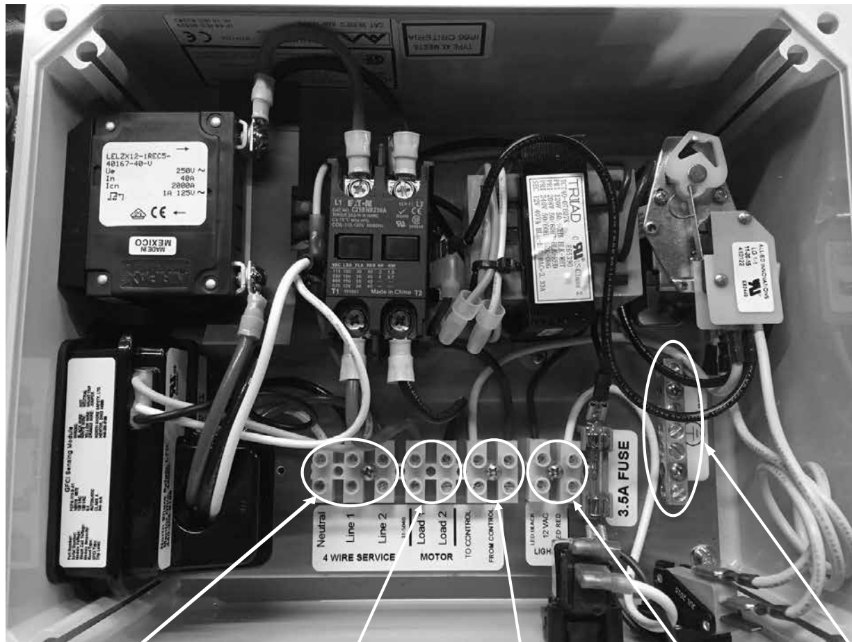
Energía del panel principal (230 VAC): Neutral, Línea 1, Línea 2 Potencia del motor de la bomba (230 VAC): Carga 1, Carga 2 Conexión al relé remoto: (120 VAC) Conexión a la luz LED (12 VAC) Conexiones a tierra del panel principal y el motor de la bomba
