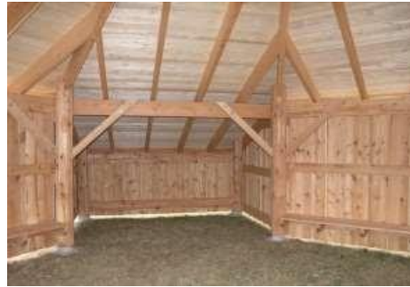
Tilbygning åben mod bålhytten og lukket mod bagvæg og sider. Ingen gulv. Egnede til opbevaring, scene, udekøkken el.lign.
