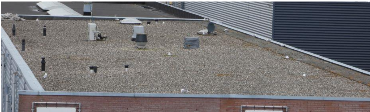
De beide grinddaken van Daalderweg Oost. Duidelijk zijn de broedende stormmeeuwen te zien. 25 mei 2021.
