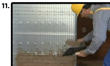
Strato di ancoraggio, detto anche rinzaffo: è il primo strato da aggregati grossolani, la superficie risultante deve essere ruvida ma priva di vuoti o di eccedenza di intonaco, per agevolare l'ancoraggio dello strato successivo.
