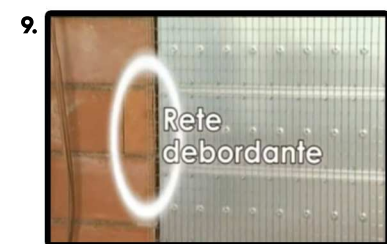
la rete del controtelaio, deborda e accavalla la tramezzatura
