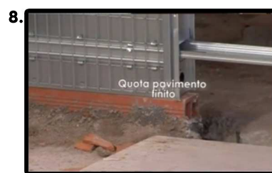
prestando attenzione al livello pavimento. I principali problemi riscontrati, sono relati alla non perfetta QUOTA PAVIMENTO.
