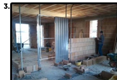
MONTAGGIO SU TRAMEZZATURA DA REALIZZARE puntellare il controtelaio e cominciare realizzare la tramezzatura, incassando il controtelaio nella muratura.
