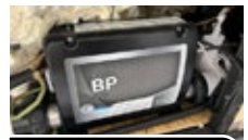
SYSTÈME DE COMMANDE DU BAIN À REMOUS
