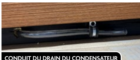
CONDUIT DU DRAIN DU CONDENSATEUR
