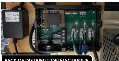
PACK DE DISTRIBUTION ÉLECTRIQUE
