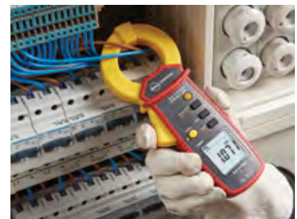
Differentiell strömmätning med läckströmtång
