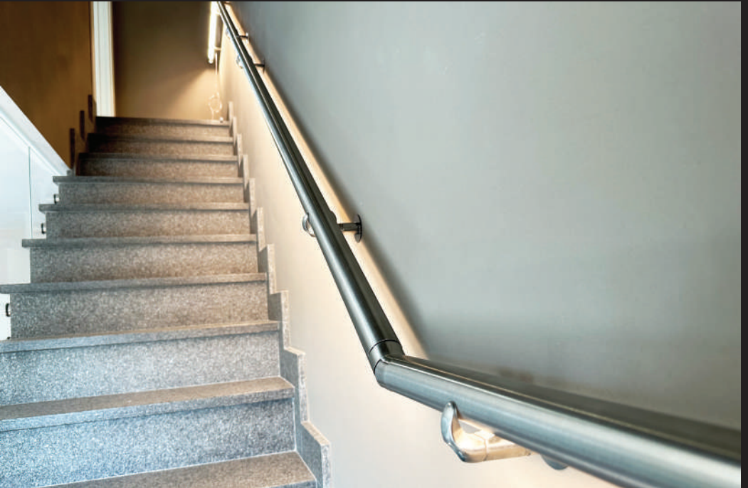
Abitazione Privata Ooi - Corrimano Scala Interna
