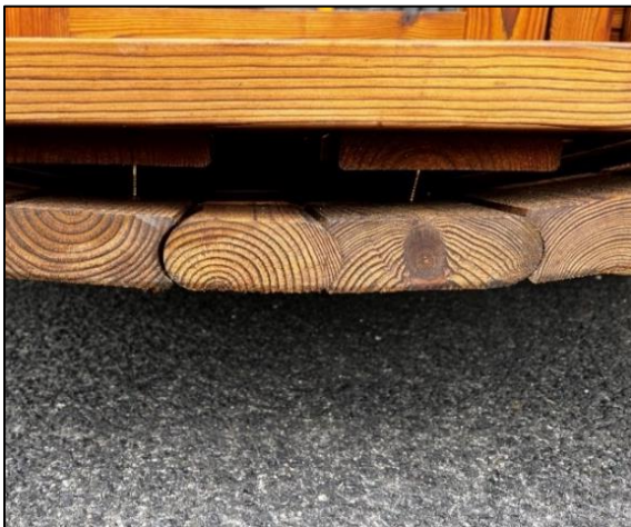
Ungleichmäßigkeiten der Holzbretter
