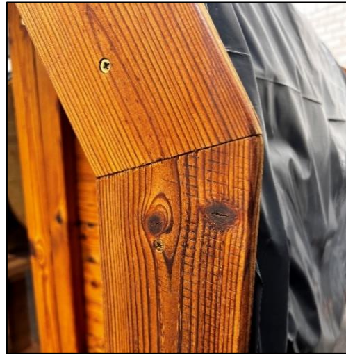
Ungleichmäßigkeiten der Holzbretter
