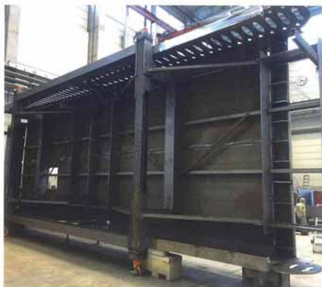
Fig. 24 | Costruzione della struttura di acciaio del ponte ciclo-pedonale in officina. © Max Streicher
