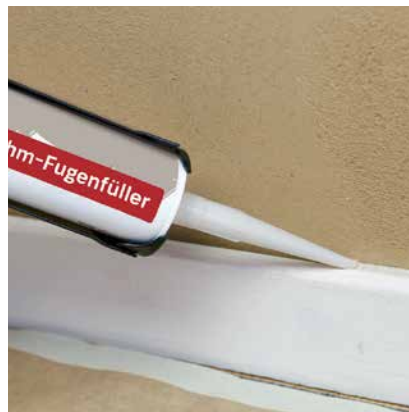
Fugenfüllung mit natur-weiß an einer Sockelleiste
