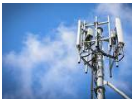
STATIONS DE BASE DE COMMUNICATION CELLULAIRE
