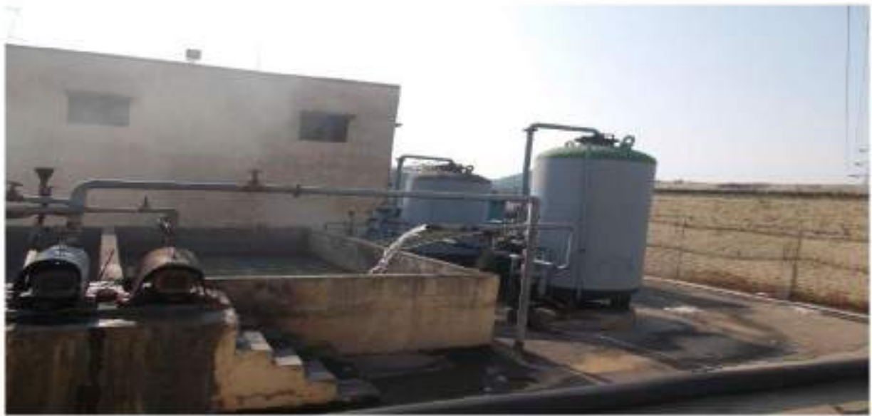
Figure1- Effluent Treatment Plant (ETP)
