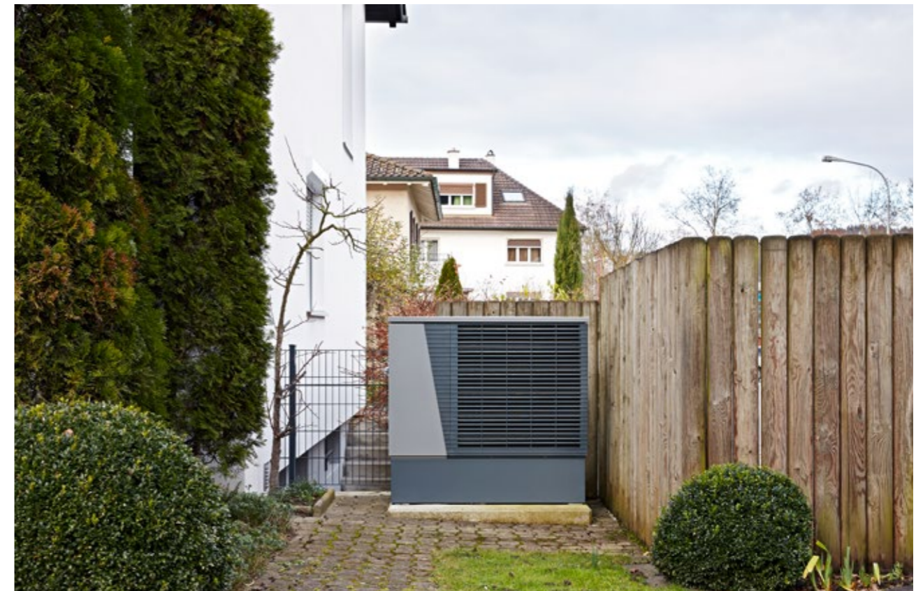
Aussen aufgestellte Luft-/Wasser-Wärmepumpe
