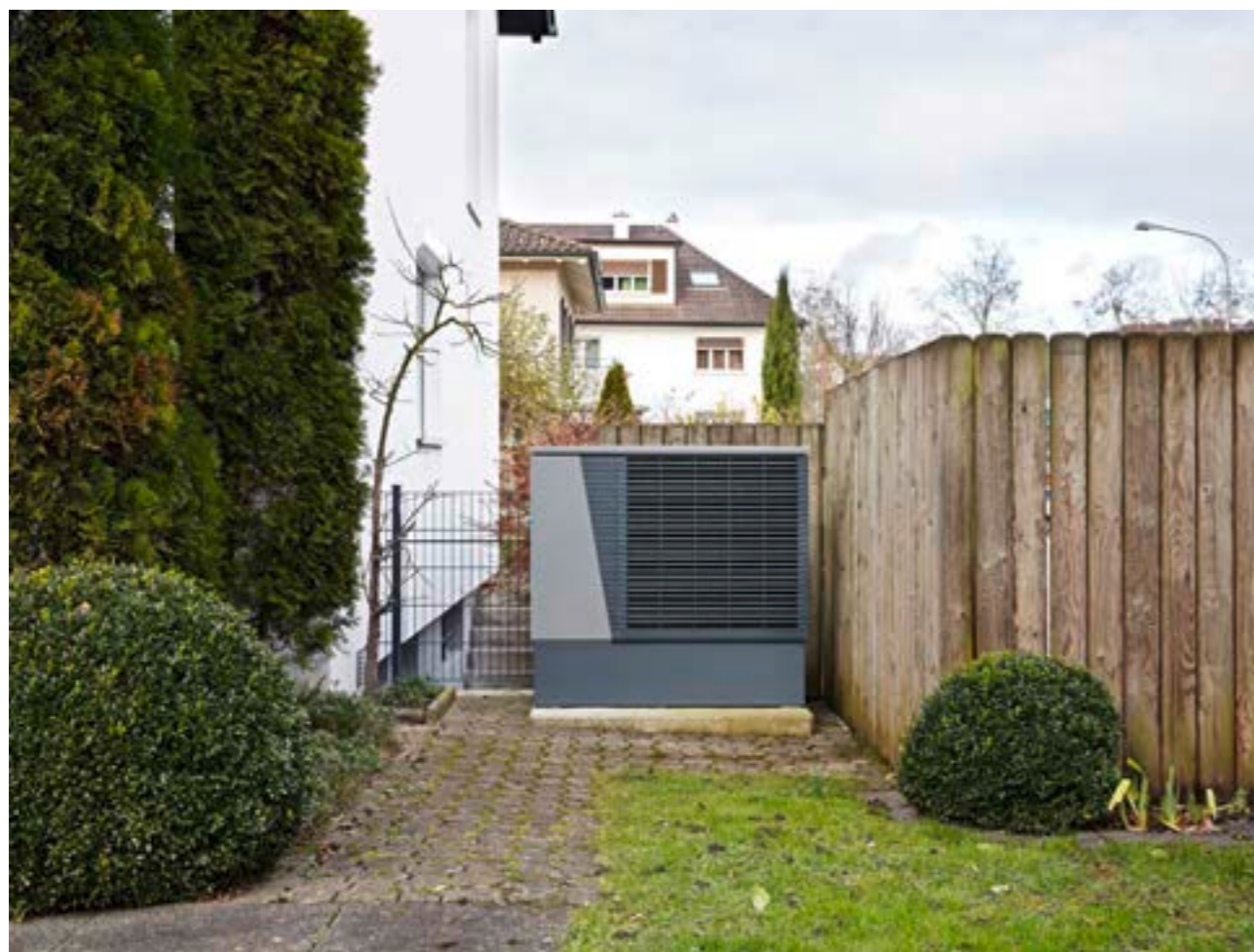
Aussen aufgestellte Luft-/Wasser-Wärmepumpe
