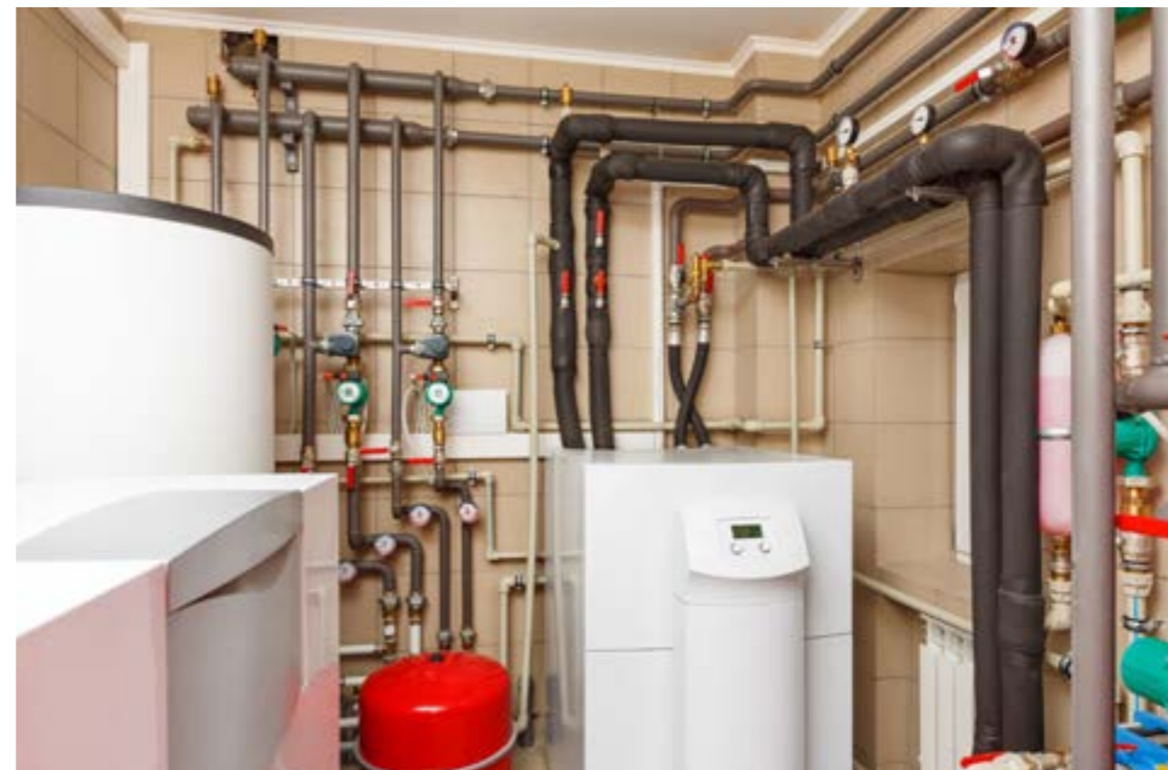
Heizraum mit Wärmepumpeninstallation
