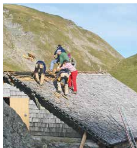
2007 musste der Schattstall auf der Alp Gumpel neu eingedeckt werden. Christian Fahrni, hier in roter Hose, half dabei auch mit.
