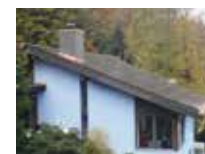
Dies ist eine der 7 Referenzanlagen der EWG, eine Indachanlage mit 26 kWp in Hondrich
