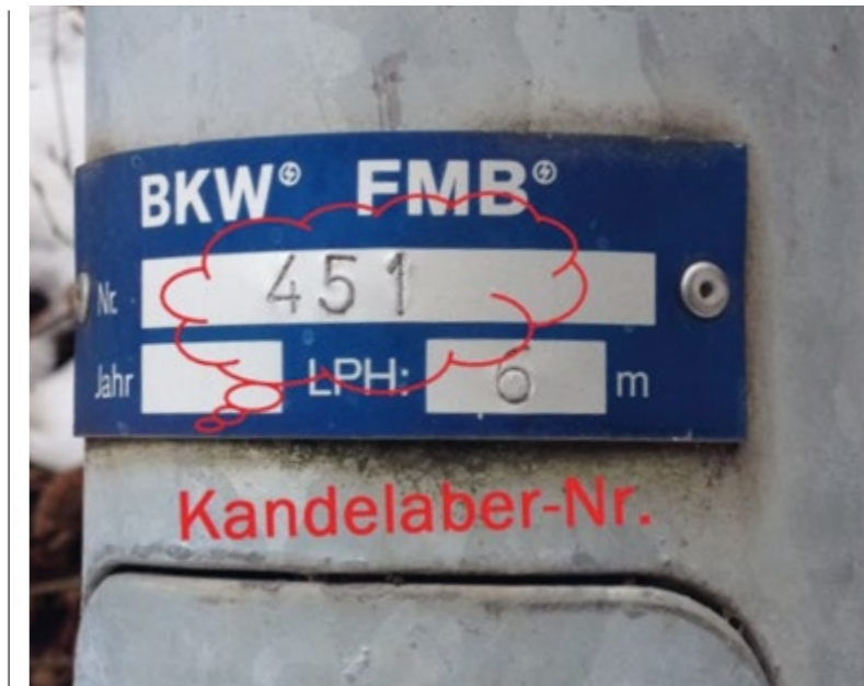
Die Kandelaber-Nummer ist auf einer Plakette am Mast der Strassenlampe abzulesen - sie ist bei der Behebung eines Schadens sehr hilfreich. Foto: zvg
