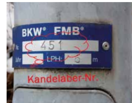
Die Kandelaber-Nummer ist auf einer Plakette am Mast der Strassenlampe abzulesen – sie ist bei der Behebung eines Schadens sehr hilfreich.
