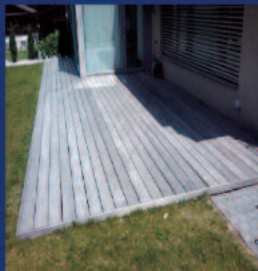
Verblasste und verschmutzte Holzterrassen grundreinigen...
