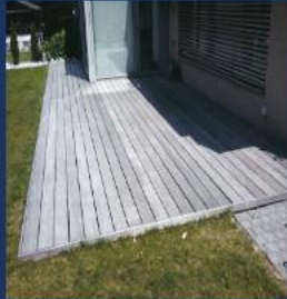
Verblasste und verschmutzte Holzterrassen grundreinigen...
