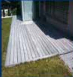
Verblasste und verschmutzte Holzterrassen grundreinigen...
