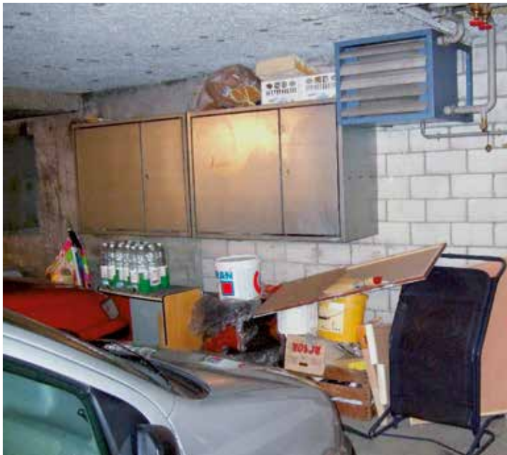
Schlechtes Beispiel einer Einstellhalle: versperrte Fluchtwege, gelagerte Materialien, welche die Brandgefahr erhöhen.
