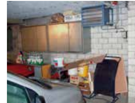
Schlechtes Beispiel einer Einstellhalle
