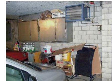
Schlechtes Beispiel einer Einstellhalle
