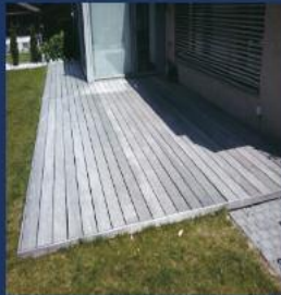
Verblasste und verschmutzte Holztterrassen grundreinigen...
