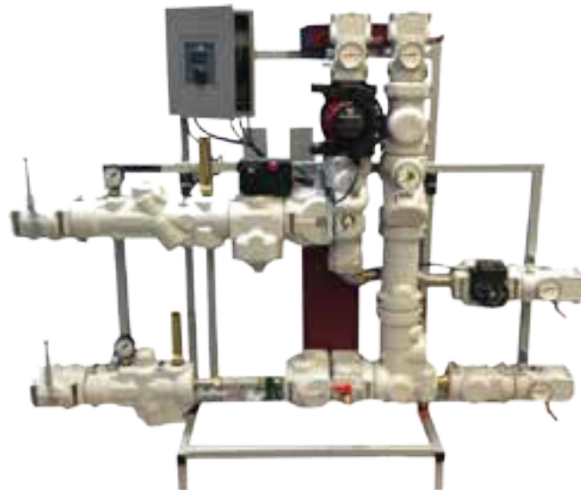
Fernwärmeunterstation für Mehrfamilienhäuser
