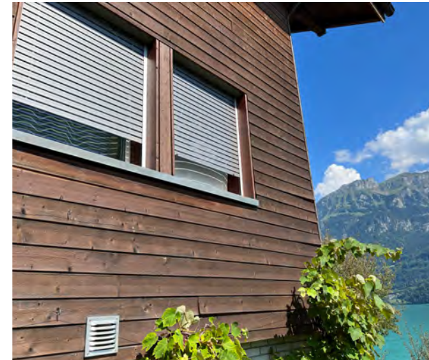
Ansicht Fassade mit Hagelschaden
